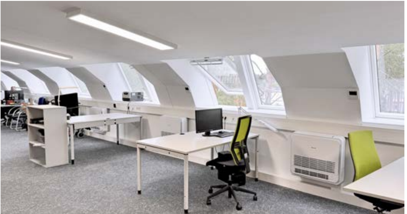
Hisense Truhengeräte: Elegante Alternative zum Heizkörper – an der klassischen Heizkörperposition montiert bieten sie effiziente Kühl- und Heizfunktionen zu jeder Jahreszeit
