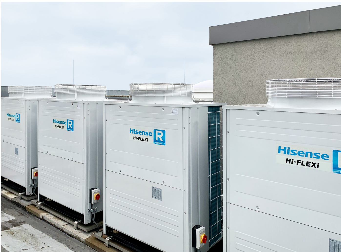
Die auf dem Gebäudedach montierten Hisense VRF-Außeneinheiten
