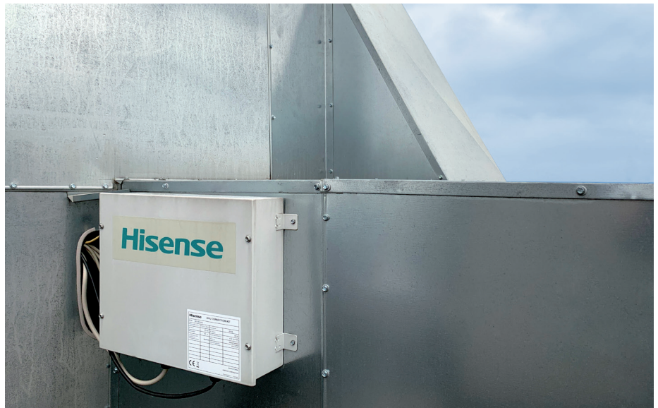
Die von außen an den Lüftungsanlagen montierte Steuereinheiten für externe Wärmeübertrager
