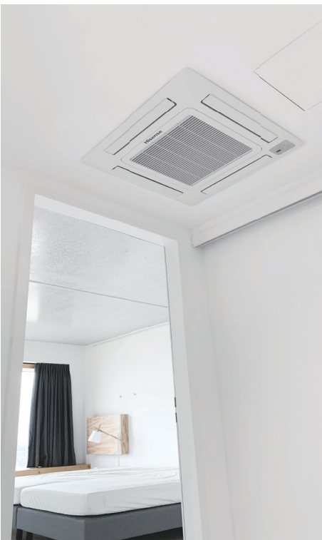
Die in den Wohneinheiten installierten Kassettengeräte sorgen für ein Wohlfühlklima
