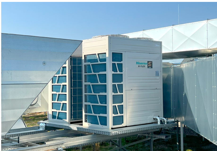
Die VRF-Außengeräte im Abluftstrom der Lüftungsanlage platziert, um den Wirkungsgrad zu steigern und die Abtauzyklen zu reduzieren
