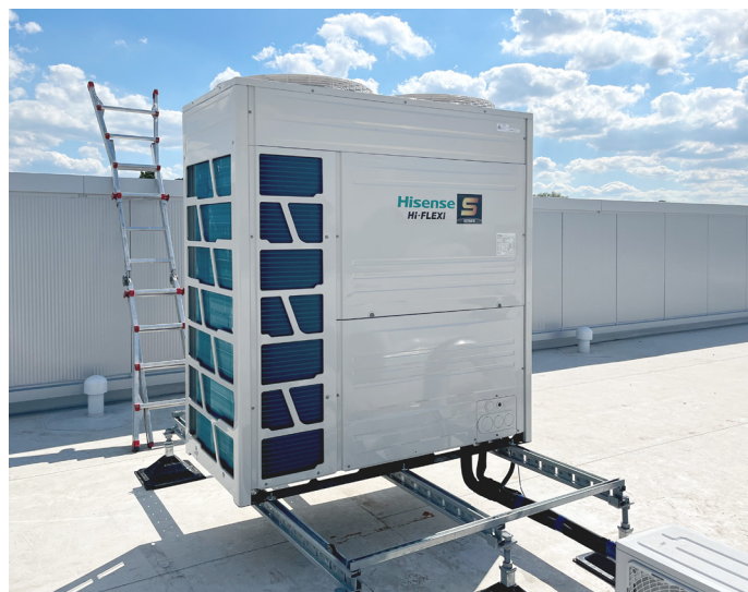
Die auf dem Gebäudedach installierte Außeneinheit
