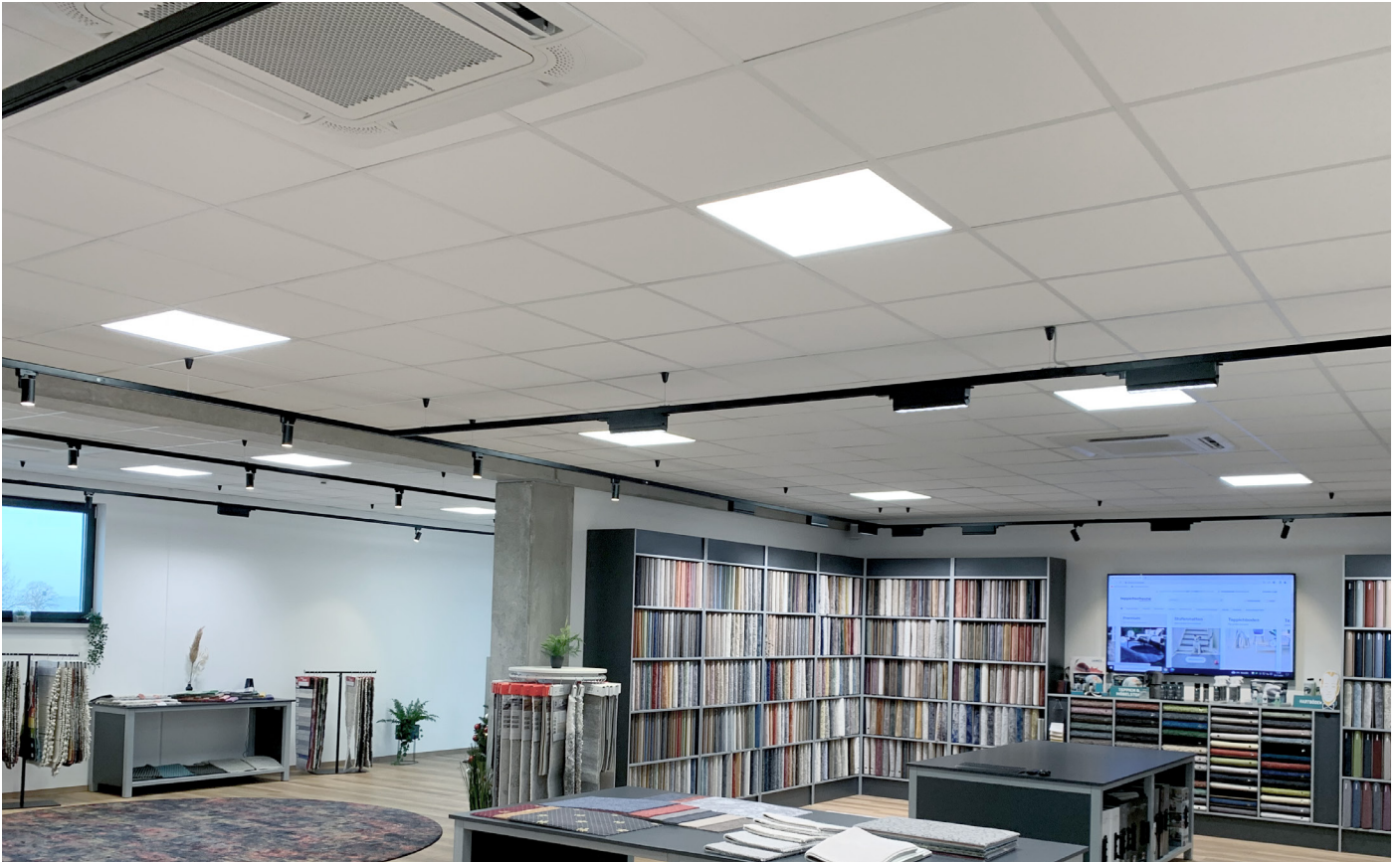
Hisense Kassettengeräte im Showroom der Teppichscheune
