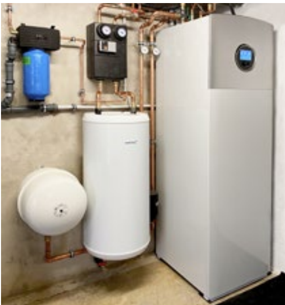
Inneneinheit, Trinkwasser- und Pufferspeicher, Ausdehnungsgefäße und die dazugehörige Mischerguppe wurden nach der VDI 4645 ausgelegt
