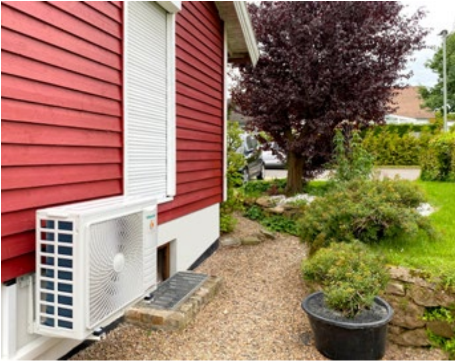
Die unter Berücksichtigung gesetzlicher Vorgaben zu Schallemissionen aufgestellte Hisense 8 kW Außeneinheit
