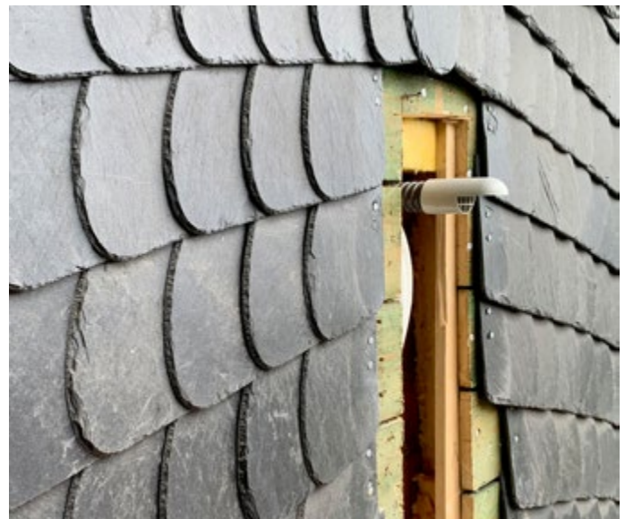
Von außen ist lediglich nur der Lufteintritt für die Frischluftzufuhr sichtbar, die Rohrleitungen wurden hinter der verschieferten Fassade verlegt.
