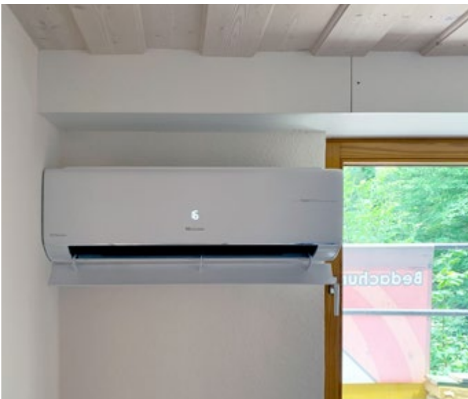
An der Außenwand montiertes Innengerät, der Frischluftschlauch wurde geradeaus nach hinten herausgeführt, andere Schlauchführungen sind problemlos möglich.
