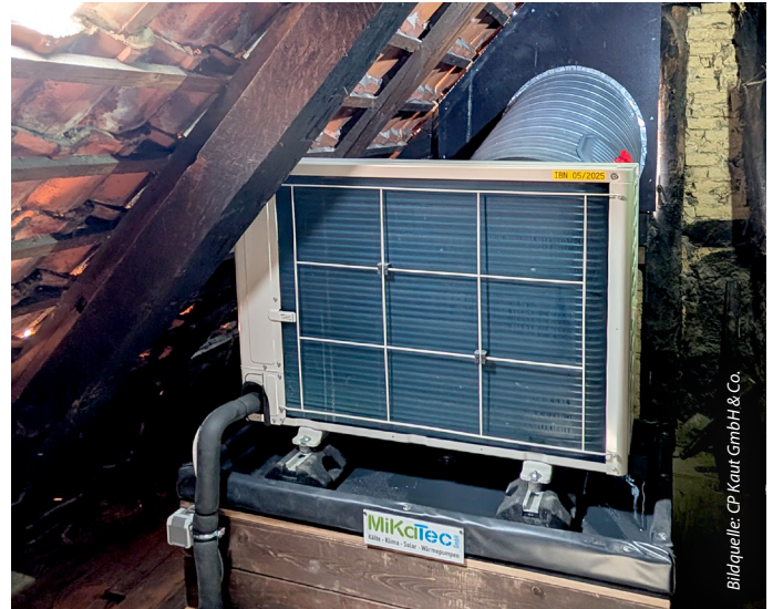
AWH-120 Außeneinheit von Hisense im Spitzboden des Gebäudes
