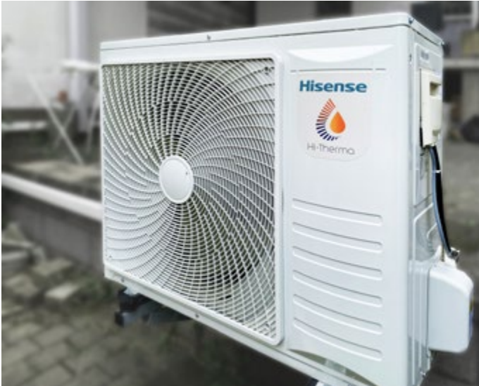
Die unter Berücksichtigung gesetzlicher Vorgaben zu Schallemissionen aufgestellte Hisense Außeneinheit
