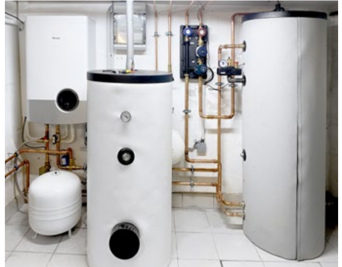
Inneneinheit, Trinkwasser- und Pufferspeicher, Ausdehnungsgefäße und die dazugehörige Mischerguppe wurden nach der VDI 4645 ausgelegt
