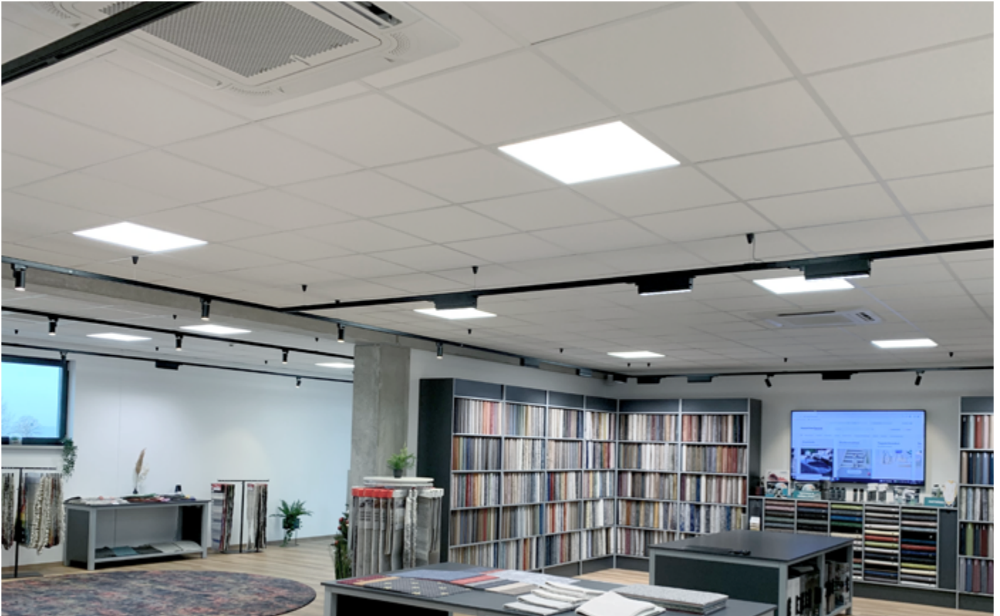
Hisense Kassettengeräte im Showroom der Teppichscheune
