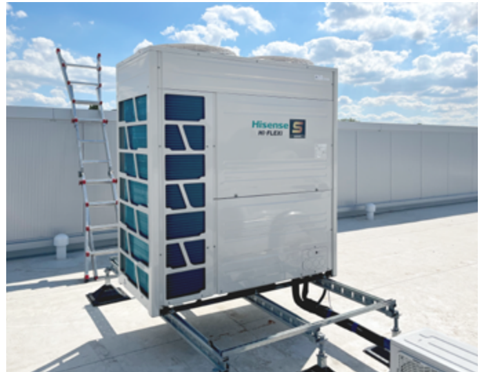
Die auf dem Gebäudedach installierte Außeneinheit
