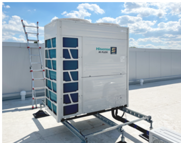
Die auf dem Gebäudedach installierte Außeneinheit
