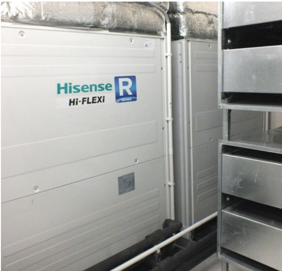
Hisense VRF-Außeneinheiten mit Kanalanschluss im Brandschutzbereich F90
