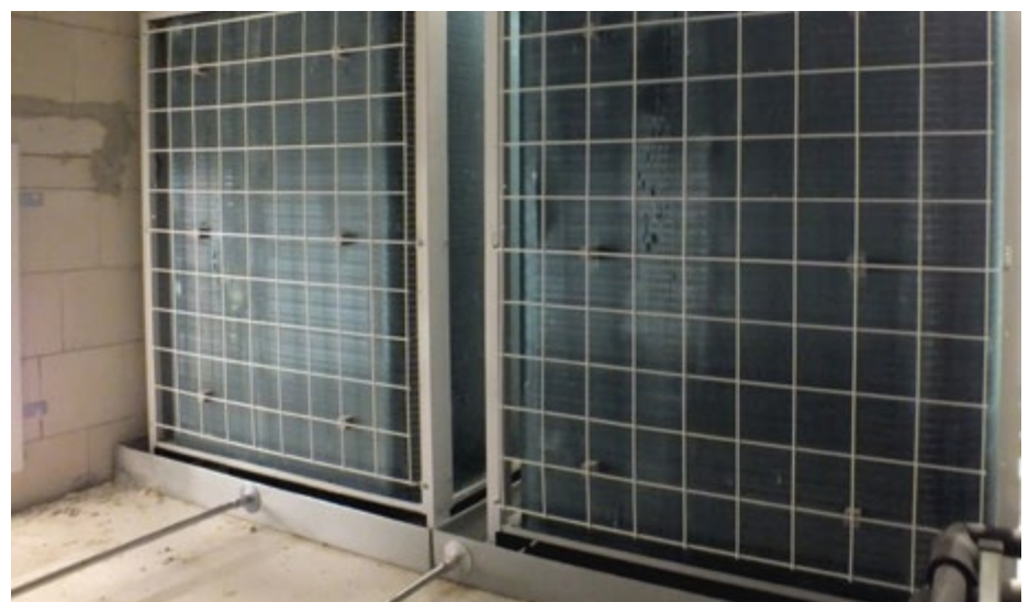
Hisense VRF-Außeneinheiten mit Kanalanschluss im Brandschutzbereich F90
