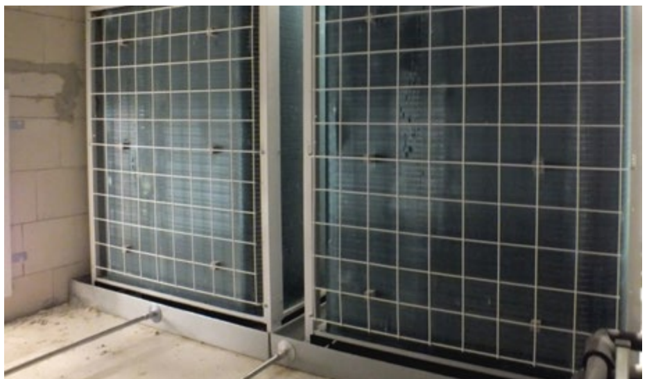
Hisense VRF-Außeneinheiten mit Kanalanschluss im Brandschutzbereich F90
