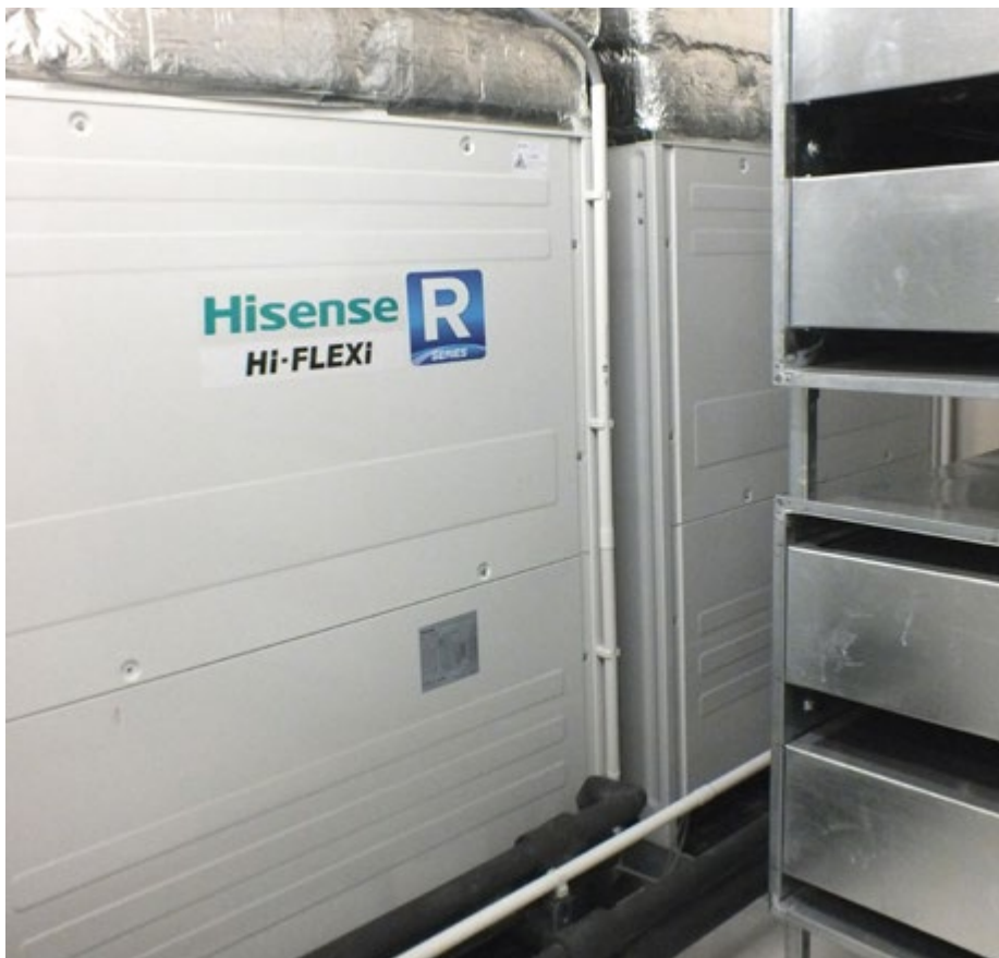
Hisense VRF-Außeneinheiten mit Kanalanschluss im Brandschutzbereich F90
