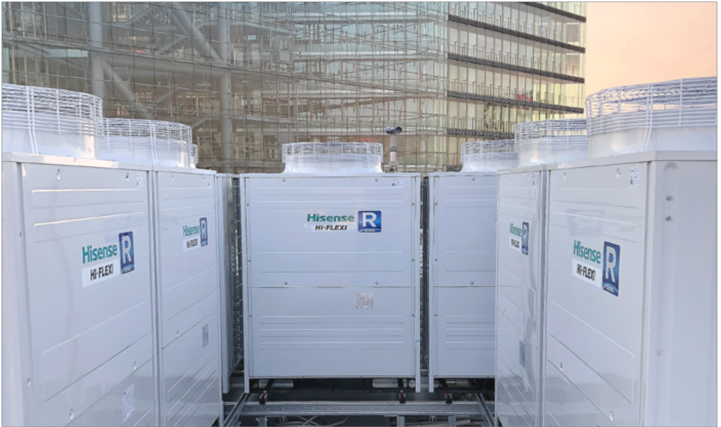
VRF-Außeneinheiten auf dem Gebäudedach
