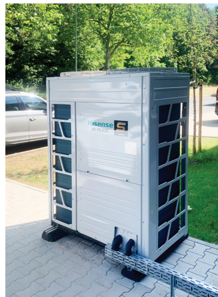
VRF-Außengerät aufgestellt im Eingangsbereich des Gebäudes
