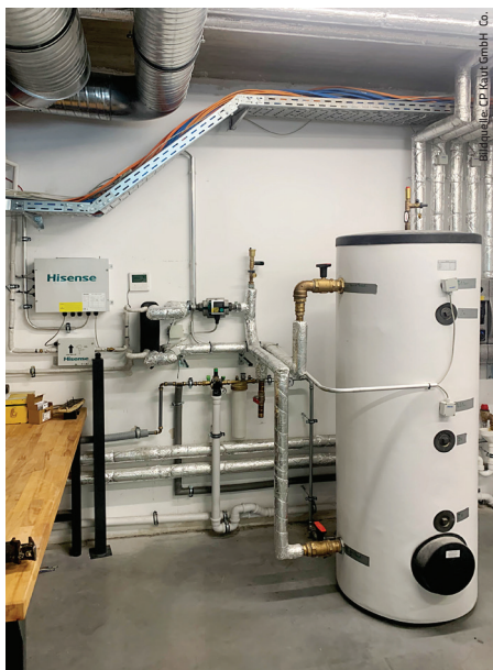
HZX-Steuereinheit mit Plattenwärmeübertrager und Pufferspeicher
