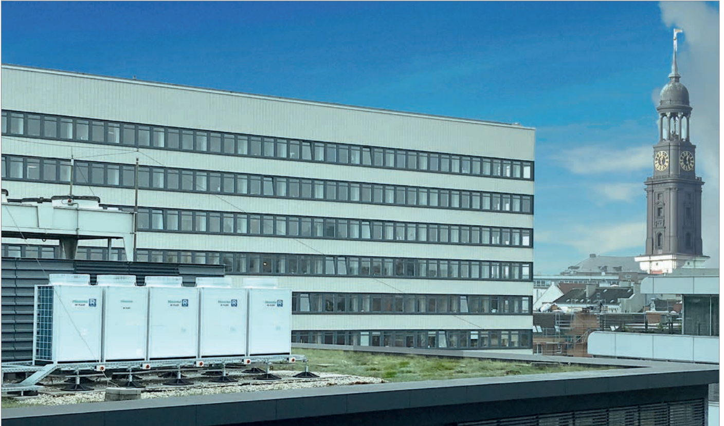
Hisense VRF-Außeneinheiten der Serie R auf dem Gebäudedach.
