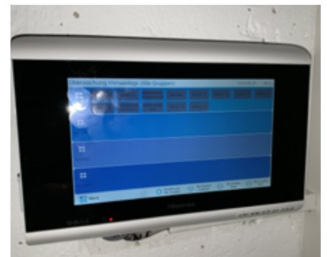
Zentralsteuerung mit Touch-Screen
