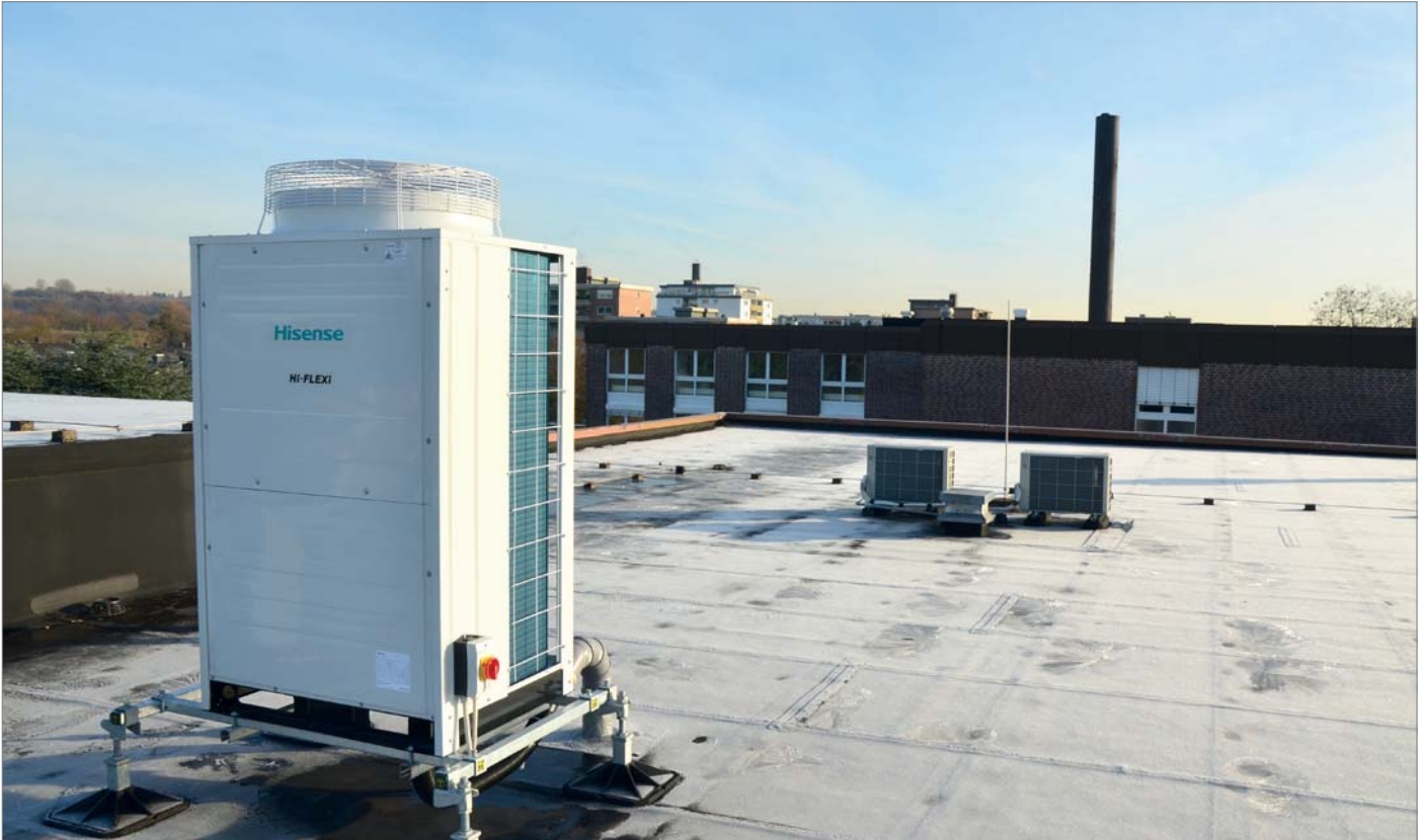
Hisense VRF-Außeneinheit der Serie R auf dem Gebäudedach.
